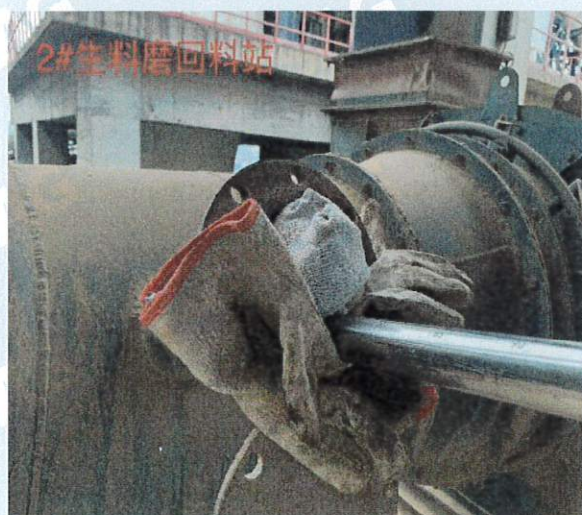
DA007 2#生料磨回料站
