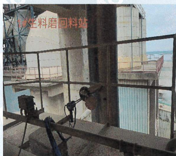
DA005 1#生料磨回料站
